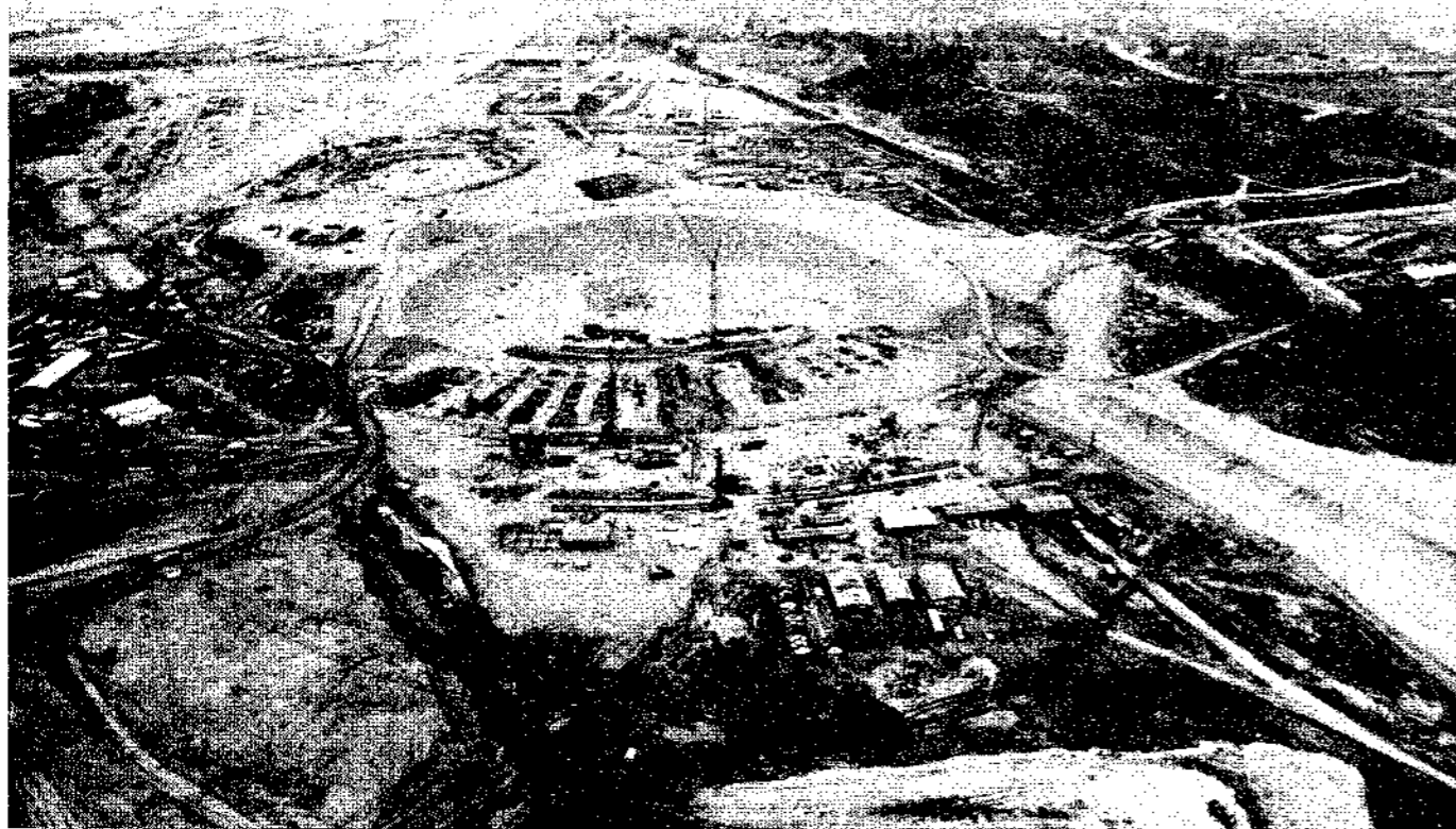
Le chantier, situé dans le nord de Munich, sur lequel s'élèvera le complexe olympique des Jeux de 1972, couvre environ 2800 km 2 . La première pierre a été posée le 14 juillet 1969. Les immenses excavations, nécessaires pour la construction des principaux emplacements sportifs, sont déjà terminées.
